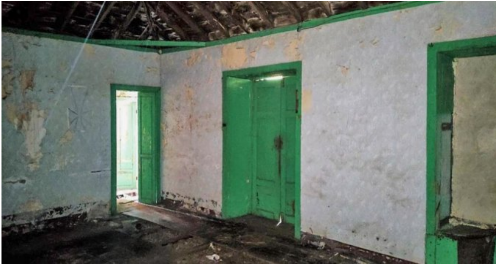
Sanierungsbedürftiger Innenbereich eines kanarischen Altbaus in El Paso.
